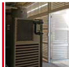
Ventilación sala de máquinas
